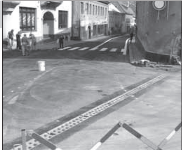
Drenážní svod vody na začátku ulice
